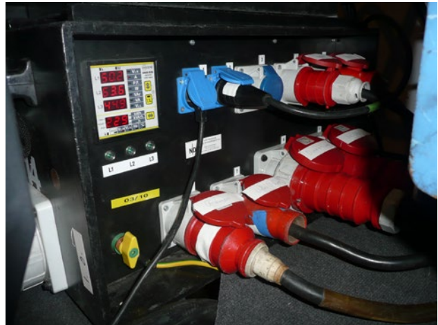
Abbildung 2: Energieversorgung am Veranstaltungsort (Foto: NDR)
